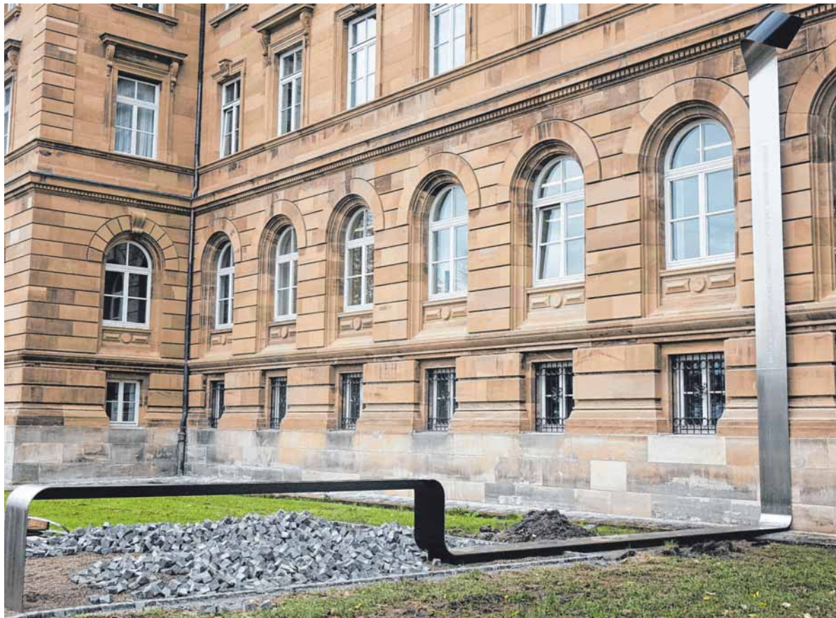
Noch sieht es vor dem Ulmer Landgericht ein bisschen wie auf einer Baustelle aus: Das Erinnerungszeichen für NS-Opfer wird am Sonntag eingeweiht. FOTO: DAGMAR HUB
